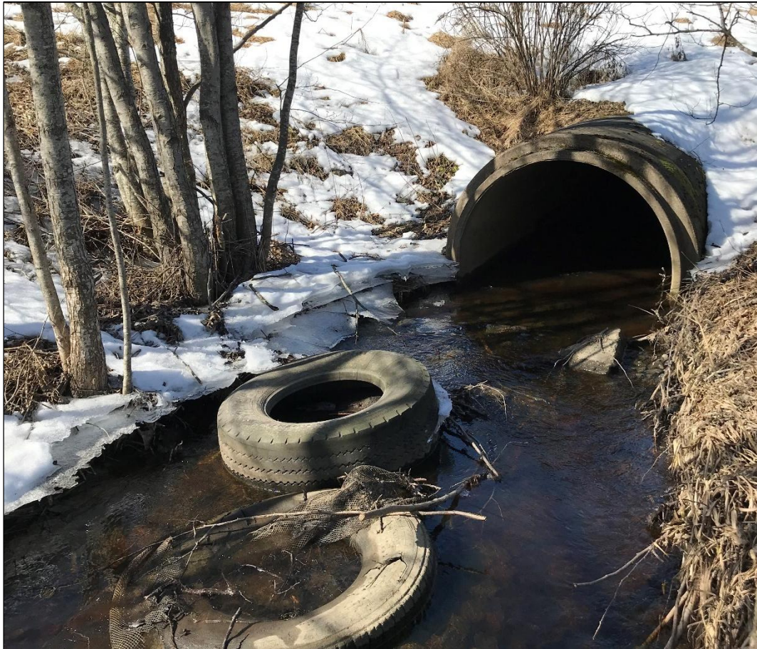
Figur 11. Dämmande bråte i form av gamla bildäck som ligger i vattendragsfåran precis nedströms struktur nr. 12. Foto: Lisa Carlsson, 2018-04-03.
