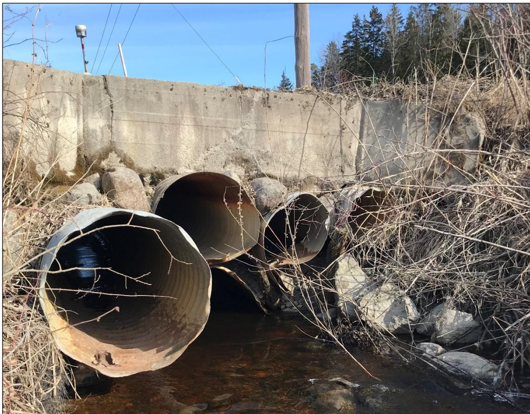
Figur 7. Struktur nr. 4. Fyra stycken parallella plåttrummor samt en halvbågeformad trumma under dessa. Den andra trumman till höger i bild är lite deformerad och diametern för denna trumma har således reducerats från uppmätt 0,5 m till 0,3 m. Foto: Lisa Carlsson, 2018-04-03.
