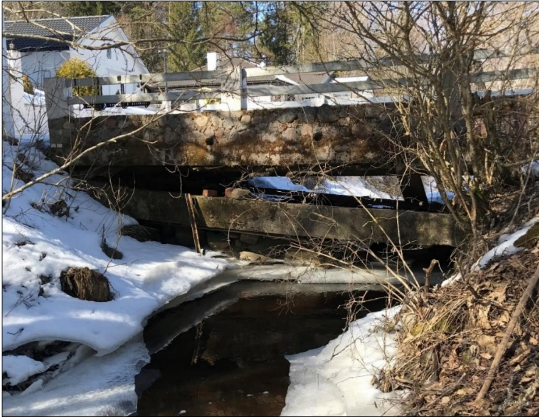
Figur 8. Struktur nr. 16. Raserad betongbro under en befintlig stenbro. Genomströmningsarean var svår att fastställa vid mätningar och den är således endast en grov uppskattning. Foto: Lisa Carlsson, 2018-04-03.
